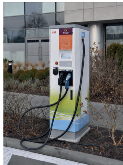
— Stacja Terra 53 C3T przed siedzibą główną Grupy Energa, Gdańsk.
